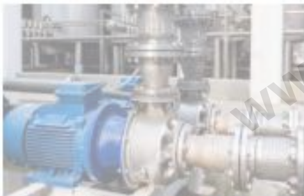
BOMBAS DE AGUA
