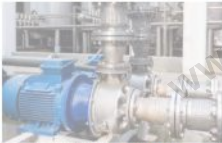
BOMBAS DE AGUA
