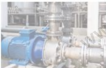
BOMBAS DE AGUA
