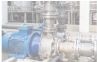
BOMBAS DE AGUA
