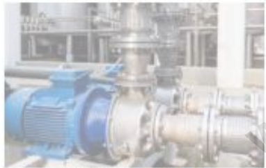
BOMBAS DE AGUA
